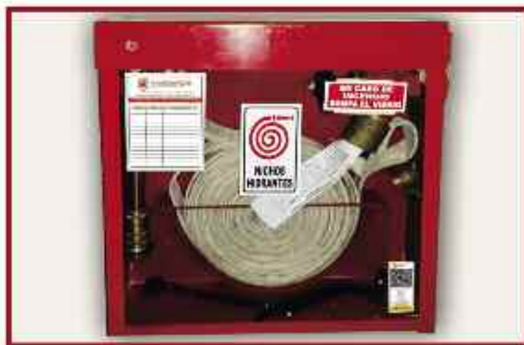
Instalación mantenida correctamente
